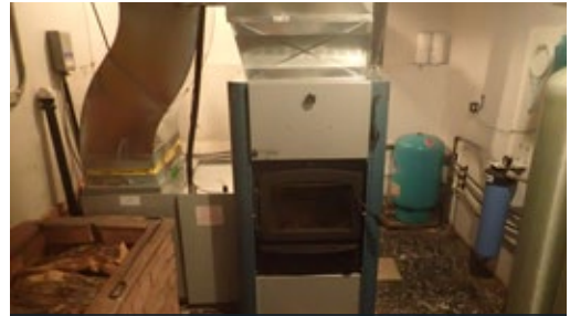
Figure 14. Générateur d'air chaud au bois de chauffage avec système d'appoint électrique et stockage du bois à l'intérieur.
