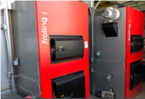
Figure 17. Chaudières aux copeaux de bois installées au Confederation College. Chaque chaudière peut donner une production d'électricité de base de 500 kW. Ces chaudières répondent à 85 % des besoins de chauffage des locaux de l'installation de 400 000 pi 2 . (Photo : Biothermic)
