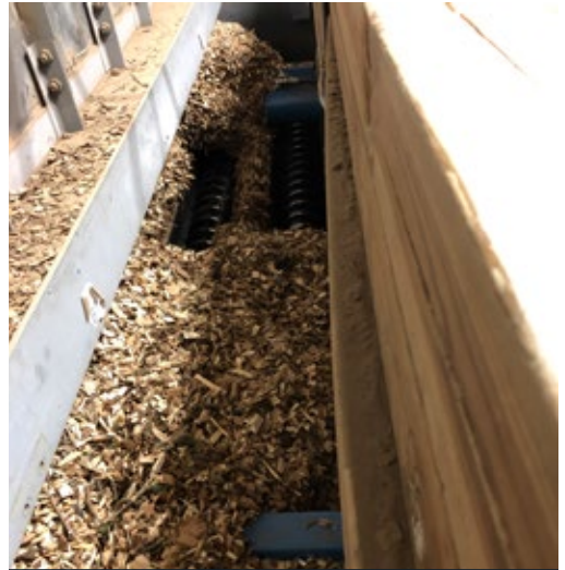
Figure 28. Une série de transporteurs à vis alimentent automatiquement les chaudières en copeaux lorsque plus de copeaux sont demandés par le système de contrôle de la chaudière. (Photo : Biothermic)
