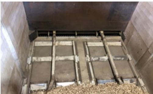
Figure 27. Vue aérienne du local de collecte des copeaux de bois du Confederation College, réalisé par Evergreen BioHeat. Le plancher racleur qu'on voit ici déplace les copeaux sur toute la longueur du local jusqu'à une série de transporteurs à vis. (Photo : Biothermic)
