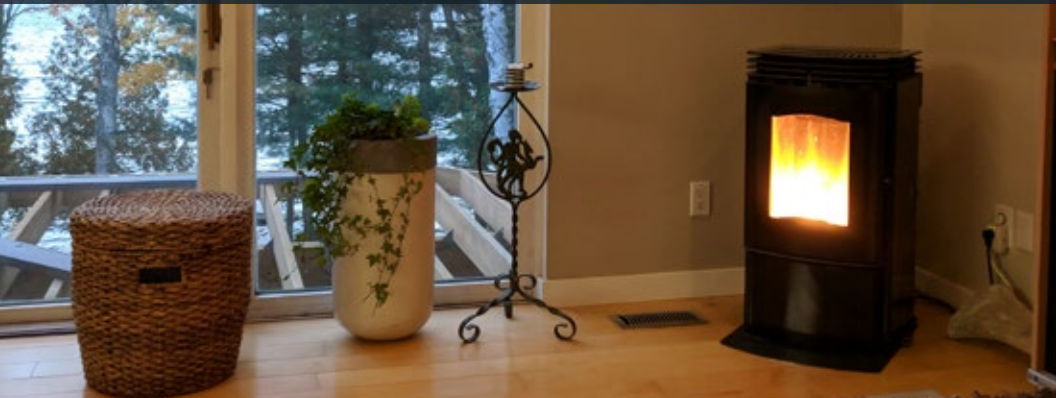
Figure 11. Un poêle à granules de bois résidentiel. Des sacs partiels de granules sont stockés dans le panier (à gauche) jusqu'à ce qu'on en ait besoin. Ce poêle fournit de la chaleur durant toute l'année pour cette maison de dimensions typiques, consommant environ 200 sacs de granules (3,6 tonnes). (Photo : Innovations Initiatives Ontario North)
