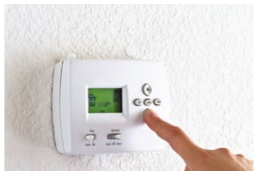
Figure 15. Les thermostats modernes contrôlent les systèmes de combustion. (Photo : SBI)
