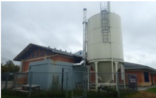
Figure 18. Système de chaudière aux granules en conteneur avec un silo agricole pour le stockage des granules qui est utilisé pour chauffer une école. Ce type de système en conteneur peut servir pour les systèmes de chaudières au bois de chauffage, aux copeaux de bois ou aux granules.
