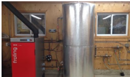
Figure 16. Chaudière au bois de chauffage de 30 kW utilisée pour fournir de la chaleur à une maison ou à un petit immeuble de bureaux. On voit à droite le réservoir de stockage de l'eau chaude (2 250 L) servant à stocker l'énergie et à accroître l'efficacité du système. (Photo : Biothermic)
